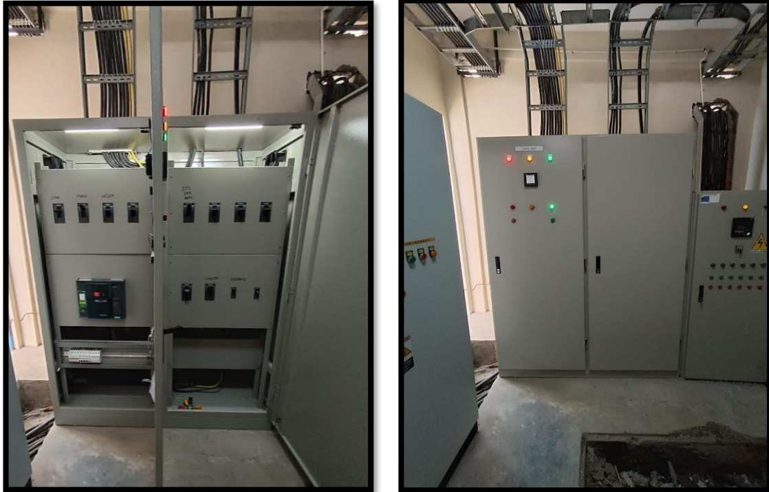
Gambar 19 Sarana Prasarana Listrik Tegangan Menengah
